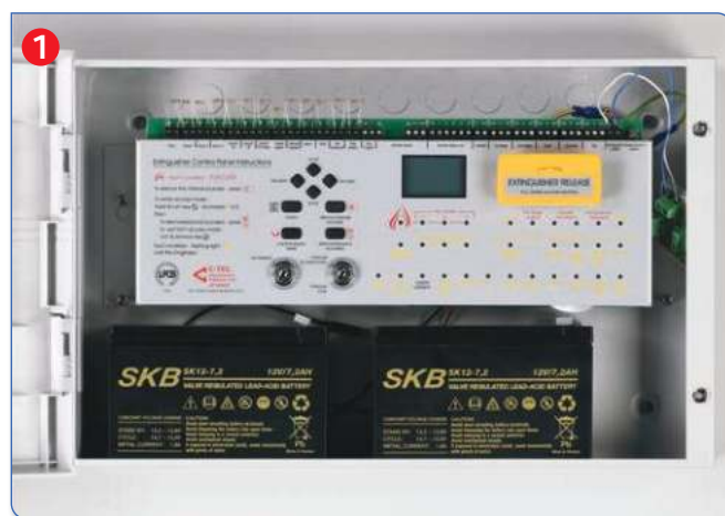
Centrale di spegnimento automatica
